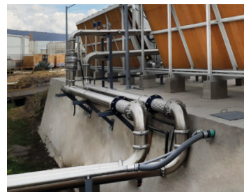
AGUA DE ENFRIAMIENTO
